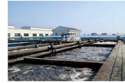
洗涤污水处理 Washing sewage treatment
