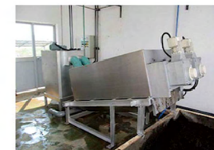
洗涤污泥处理 Washing sludge treatment
