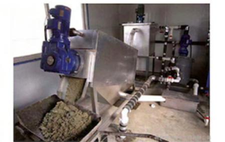
活性污泥处理 Activated sludge treatment
