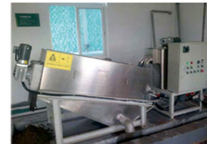
自来水厂处理 Water treatment plant
