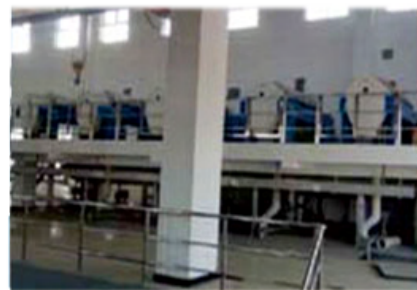
城市污水处理 Urban sewage treatment
