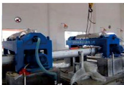
城市污水处理 Urban sewage treatment
